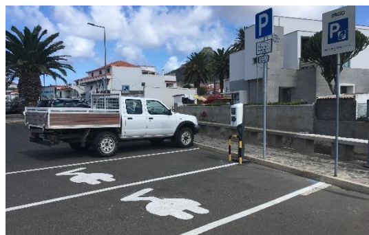
FIGURA 4.38 –POSTO DE CARREGAMENTO DE VEÍCULOS ELÉTRICOS EM PORTO SANTO
